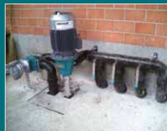
Langwellenpumpe zur Umspülung und Fassverlad mit Dreiweghahn
